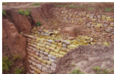
Remise en état des « dongas » : Lesotho
